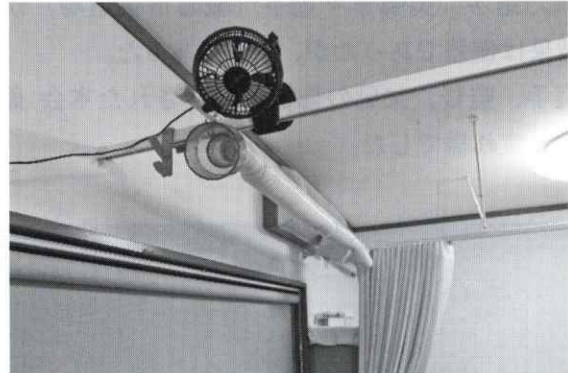
手製のエアコン送風ダクト
